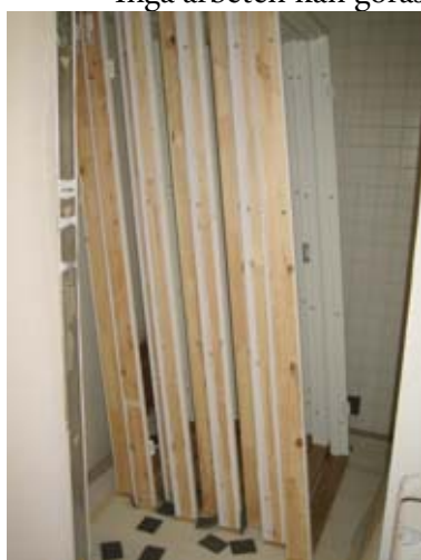
Figur 10. Dörrkarmar förvaras tillfälligt i badrum.
