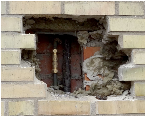
Se upp med dolda ledningar
