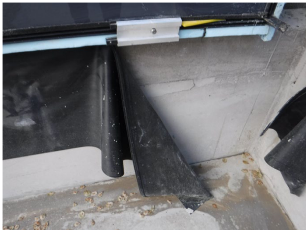
Figur 4.6.1 Gummidukar, tänkta som sekundärtätning, finns ofta färdigmonterade under dörrar och fönsterpartier. Det är ofta oklart hur monteringen ska utföras. (Foto: E Gustafsson)
