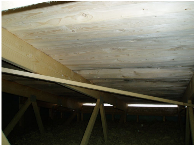
Figur 4.4.1. Skada av bristfällig tätning upp till vinden under produktionskedet, vilket föranledde byte av ett falsat plåttak. (Foto: E Gustafsson)
