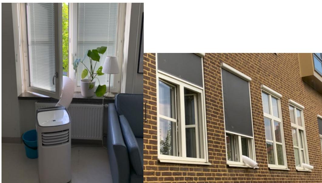
Figur 5.2 Exempel på användning av portabla luftkylare. Fönster måste stå öppna då luftkylarna används, vilket leder till att varm uteluft kommer in. Kondensvatten samlas upp i en hink. Detta trots att fönster har både mellanglaspersienn samt utvändiga screenvävar som skydd mot solinstrålning och att det finns god vädringsmöjlighet via inåtgående bågar. (Foto Helena Bülow-Hübe).
